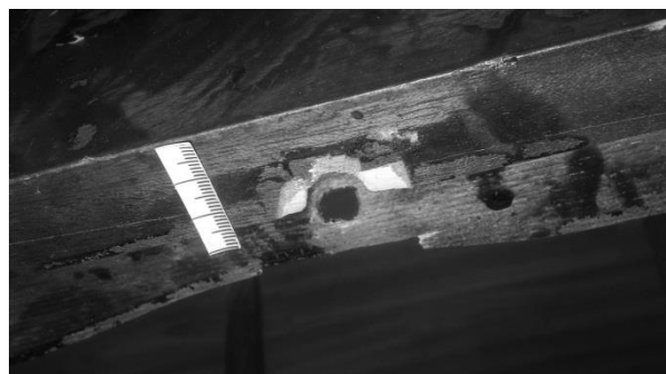
Рис. 82. Наскрізне пошкодження на зовнішній поверхні каркасної планки столешні
