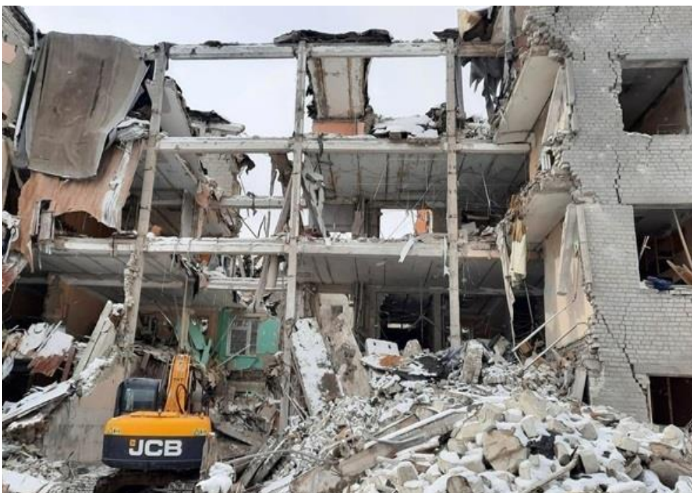
Фото: повне руйнування – реконструкція не можлива (м. Хатків)
