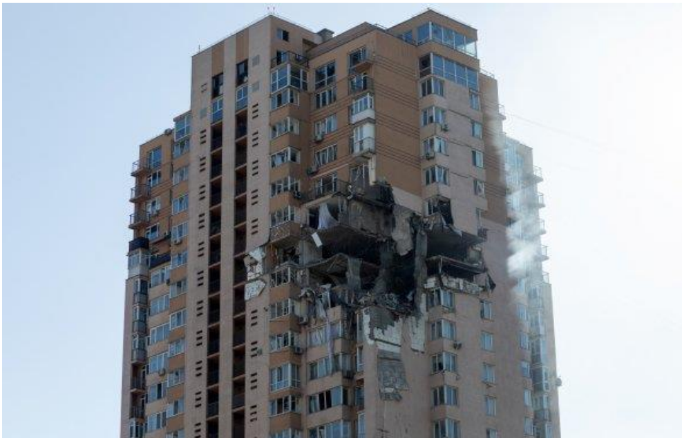
Фото: часткове руйнування - можлива реконструкція
