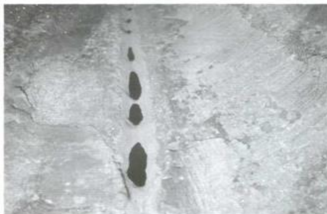
Рис.1. Щелевая коррозия в технологических трубопроводах.
